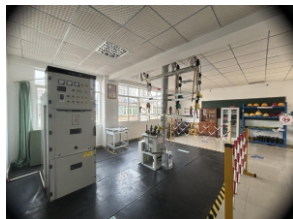
电工作业-高压电工作业 实际操作培训场地
